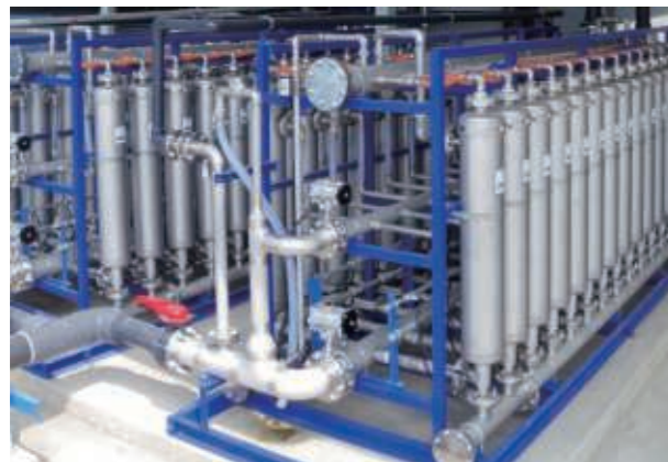
工業用水製造システム
