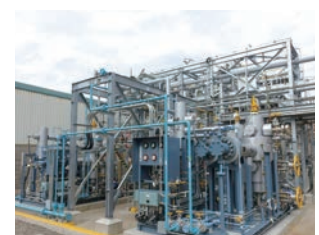
CO 2 からメタノールを高効率に製造する実証設備
