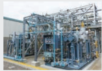
CO 2 からメタノールを製造するパイロット設備
