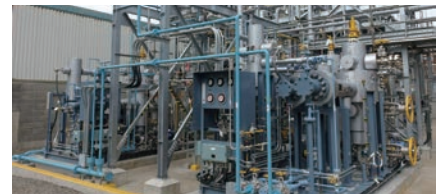
CO 2 からメタノールを製造するパイロット設備
