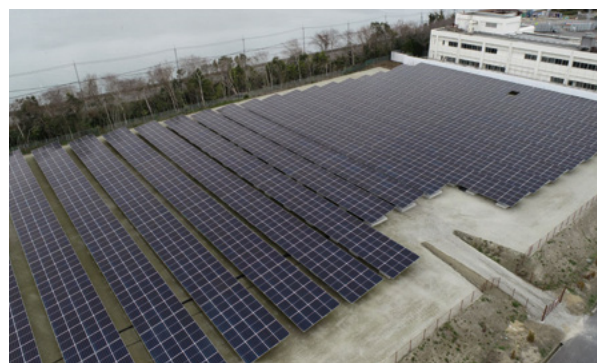
宇部工場のPPA大規模太陽光発電設備
