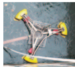
千葉石油化学工場のポリエチレンペレット回収装置
