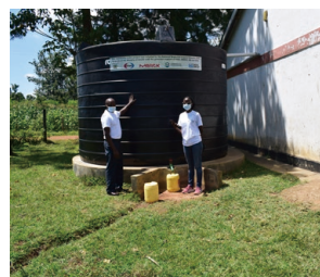
現地の学校の隣に設置された水タンク
