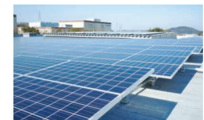
太陽光パネル(滋賀工場)
