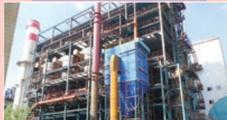
脱硫脱硝設備 (製鉄所) バケットエレベータ
