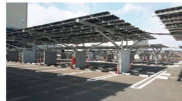
カーポート型太陽光発電システム
