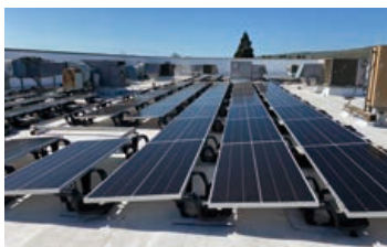
Morgan Hillに建設中の太陽光発電設備
